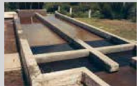
Filtro dinámico para una población rural. Nótese las cámaras de disipación a la entrada
